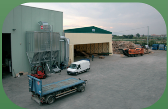
impianto abbattimento polveri
